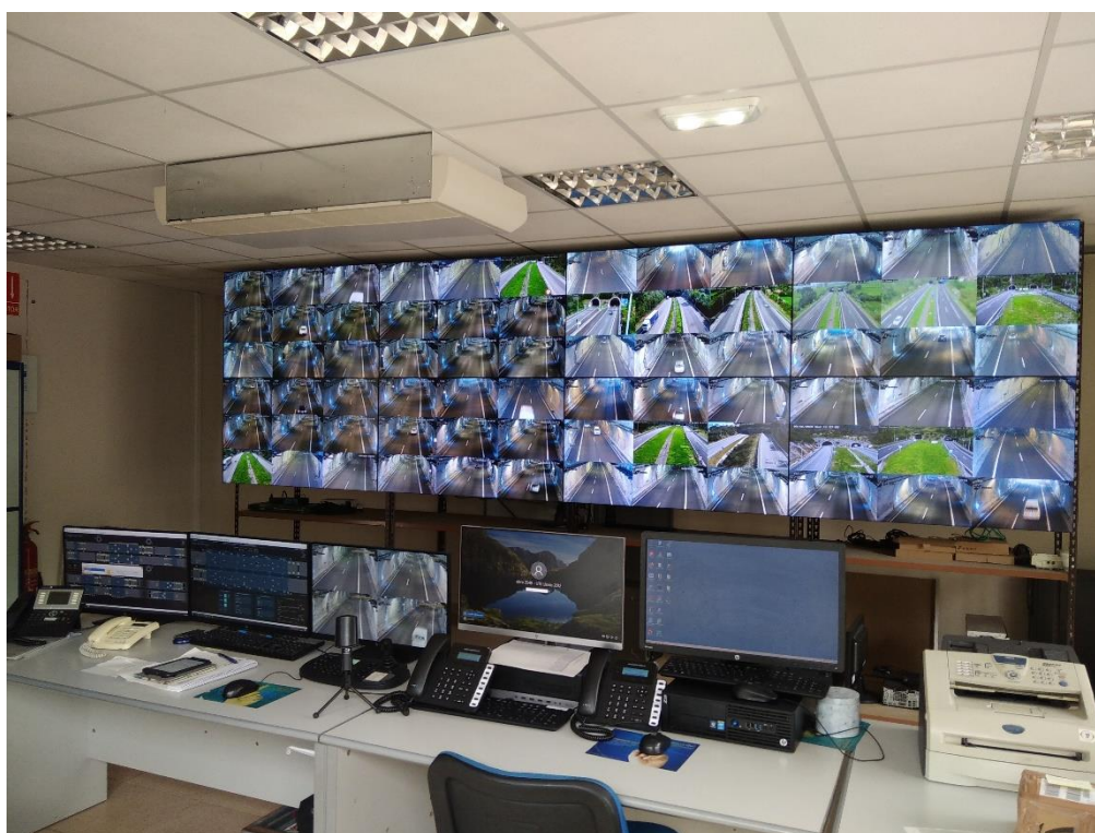
Centro de control de túneles.
